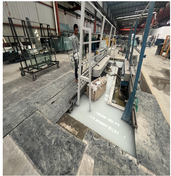
磨洗废水三级沉淀池
