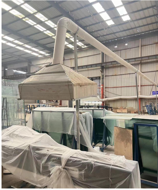
涂胶废气集气罩及管道
